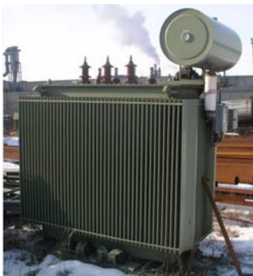
Рисунок 14.2 – Загальний вид силового трансформатора
